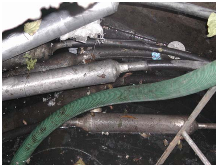
Figura 4- 11 Número excesivo de conductores instalados en una misma trinchera con evidencia de inundación
