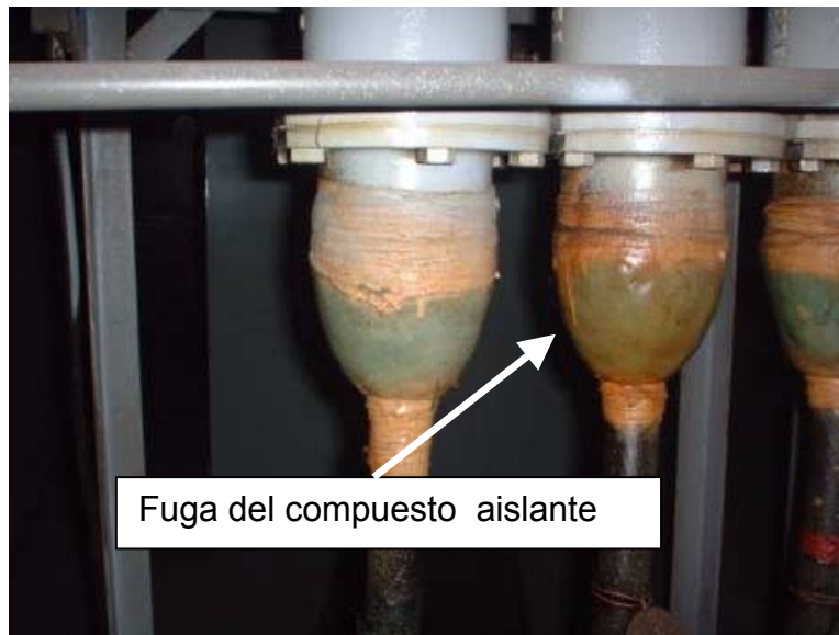
Figura 4- 10 Terminales con fuga severa de compuesto impregnante
