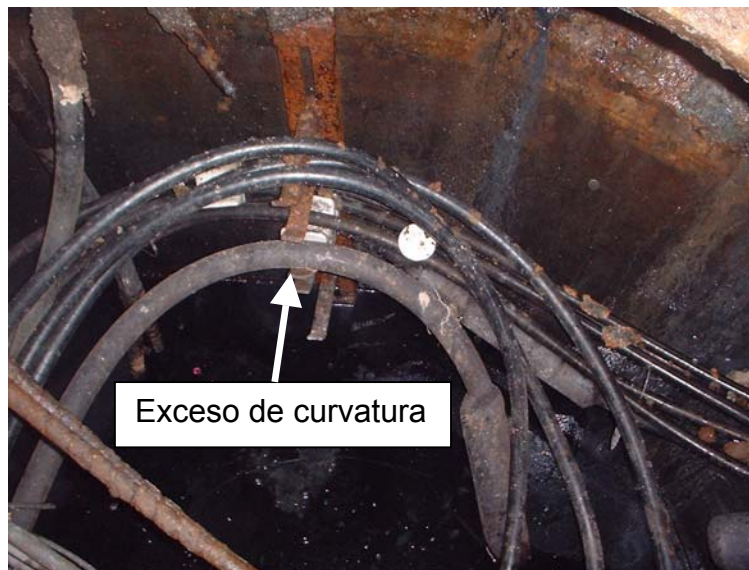
Figura 4- 9 Detalle de conductores instalados con excesivo radio de curvatura
